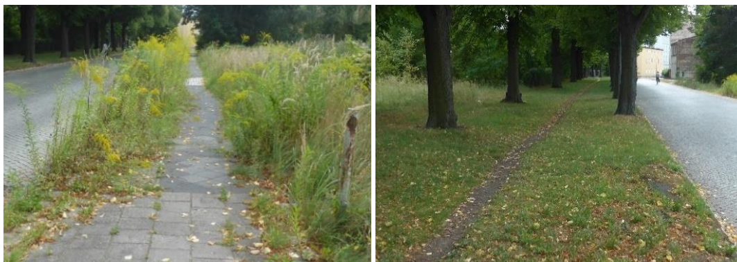
Beispiel: Gehwegzustand auf der Richard-Wagner-Straße zw. Schützenstraße und Kirchstraße
