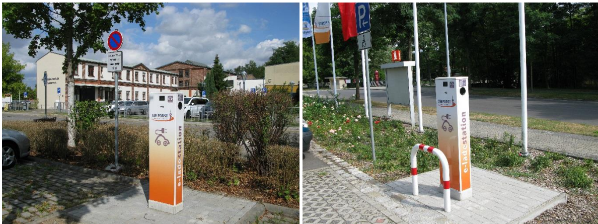
Abb. 38: Elektroladesäulen an der Kreisverwaltung Forst und am Rosengarten
